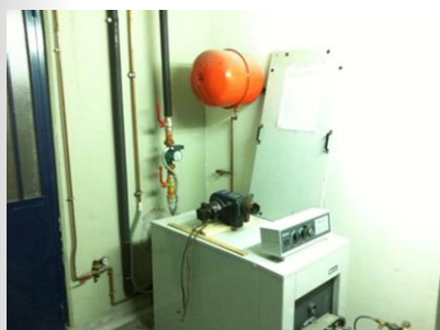
Λέβητας, καυστήρας, δοχείο διαστολής και λοιπά εξαρτήματα (μέρος της εγκατάστασης πραγματικής κλιματιστικής μονάδας)
