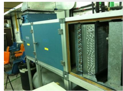
Πραγματική κεντρική κλιματιστική συσκευή (μονάδα επεξεργασίας υγρού αέρα)
