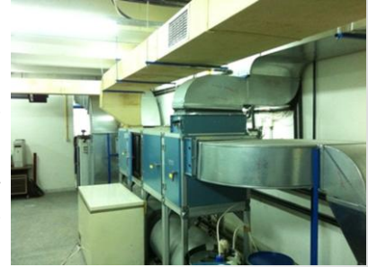
Μονάδα πραγματικής κεντρικής κλιματιστικής συσκευής με μέρος του συστήματος αεραγωγών, ψύκτη, δεξαμενές νερού, κλπ. εξαρτήματα
